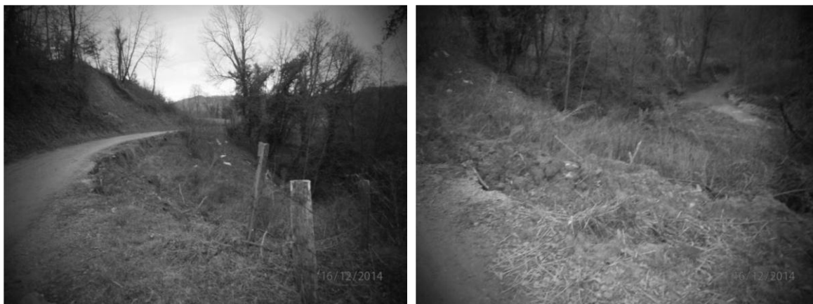
Slika 6. Čeoni ožiljak i tijelo klizišta koje prelazi u strmi nagim ka koritu rijeke
