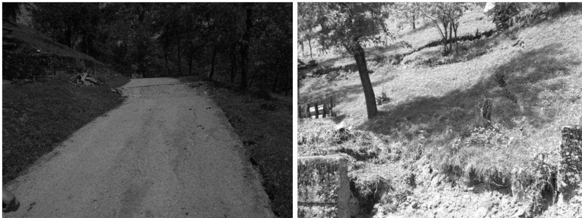
Slika 2. Izgled padine iznad oštećenog dijela puta
